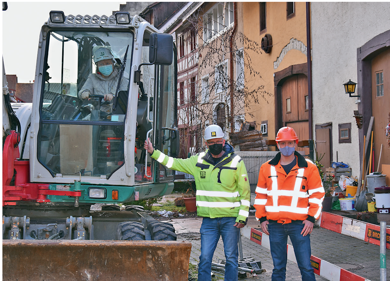
Der Spatenstich zum Projekt Sanierung und Umgestaltung Mühlengasse in Neunkirch ist erfolgt. Tiefbaureferentin Magdalena Guida (im Bagger) sowie Bauführer Heinz Ruf und Bauleiter Adrian Gugelmann (von links) freuen sich auf eine spannende Bauzeit. (Bild: sgh)
