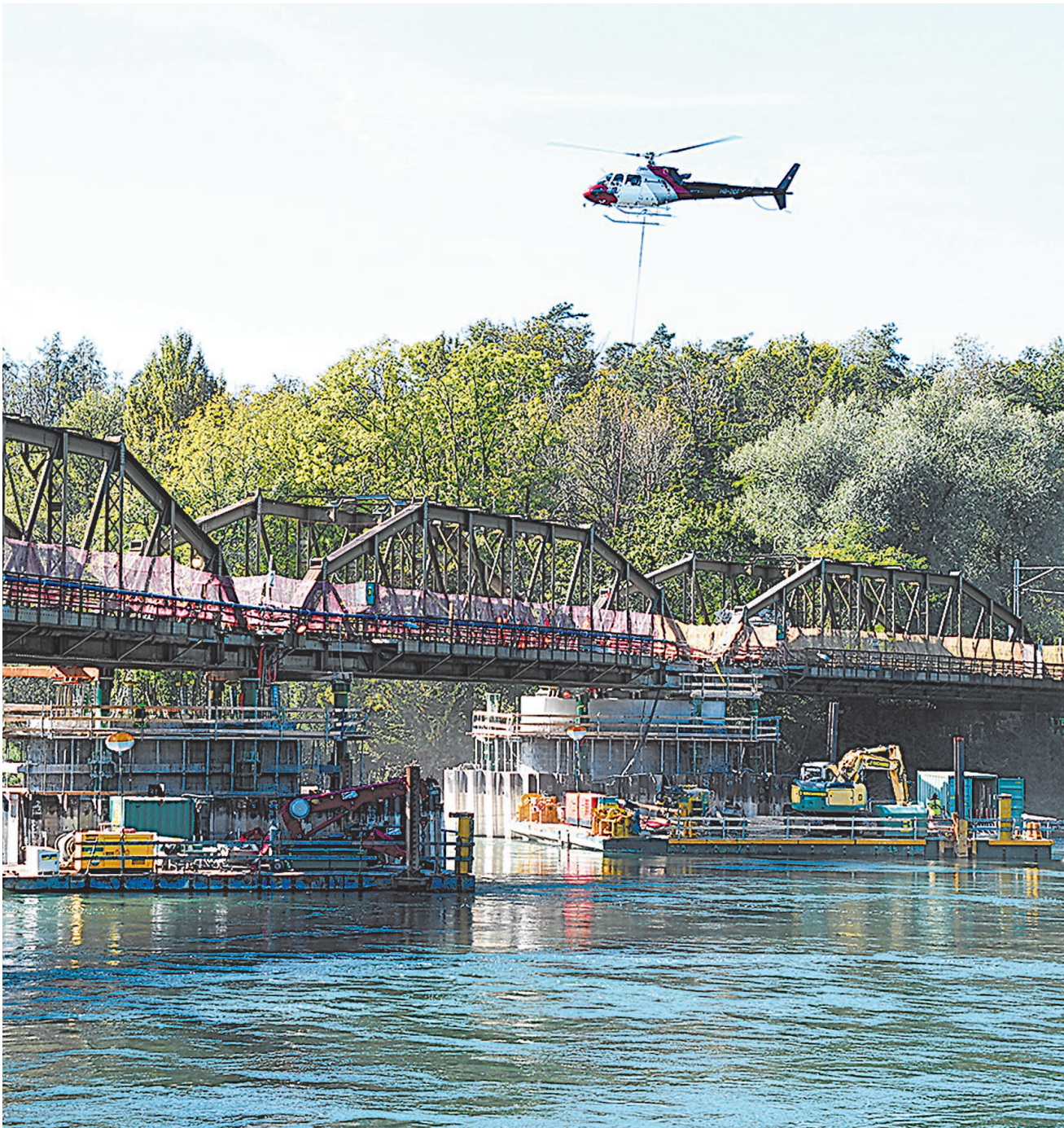
Spektakuläre Aktion bei der Baustelle der Eisenbahnbrücke Koblenz-Felsenau: Per Helikopter werden die Vorspannstangen am Freitagnachmittag zu den Brückenpfeilern geflogen.
