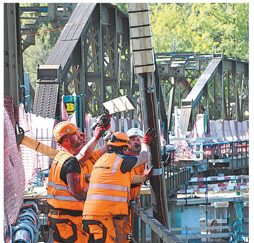
Die eingepackten Stangen werden beim «Hafen» angehoben und per Heli zur Brücke geführt, wo sie zuerst durch Arbeiter entpackt und dann zu den Pfeilern weitergefliegen werden.
