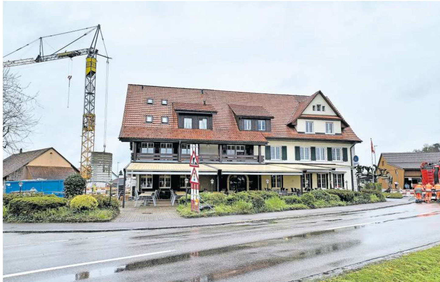
Auf der linken Seite des «Weissen Kreuzes» wird die Kreuzstube noch in Richtung Parkplätze erweitert.
